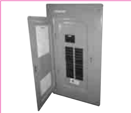
Centro de carga 30 crcuitos con Int. Principal empotrar (Figura3)
